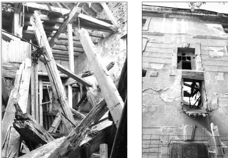
Slika 5. Stanje konstrukcije i ulične fasade objekta mlina iz 1888.
