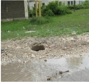
а) изглед канализационог шахта прије санације
