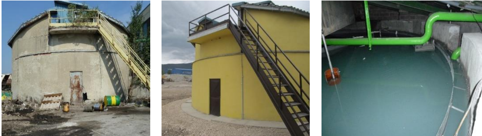
а) изглед угушћивача прије и после санације
