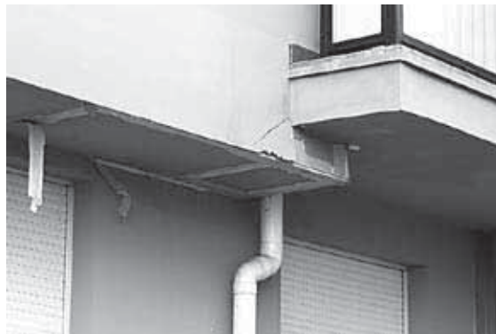
Slika 4. Loš izgled zgrade, loš kvalitet izgradnje
