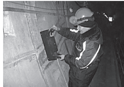
Slika 7. Primjena tomografa A1040 - procjena kvaliteta izvedenog sloja betona između betonskih panela i tla
